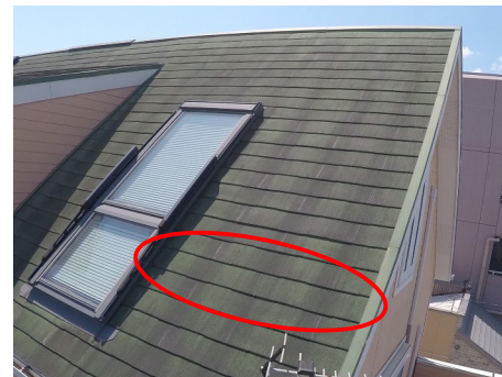
スレート屋根 浮き
