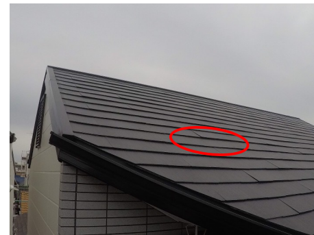
スレート屋根 浮き
