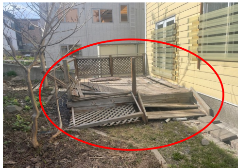
ウッドデッキ破損
