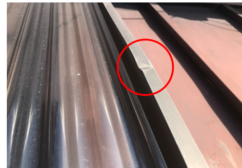
フレーム 破損
