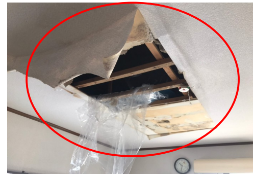
室内天井 破損
