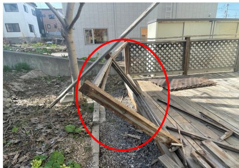
ウッドデッキ破損
