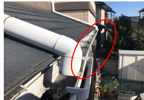
雨樋 勾配不良
