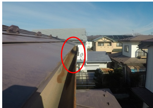
雨樋 勾配不良
