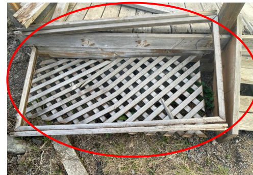
ウッドデッキ破損
