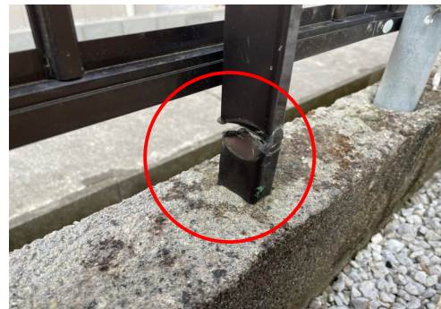
フェンス破損
