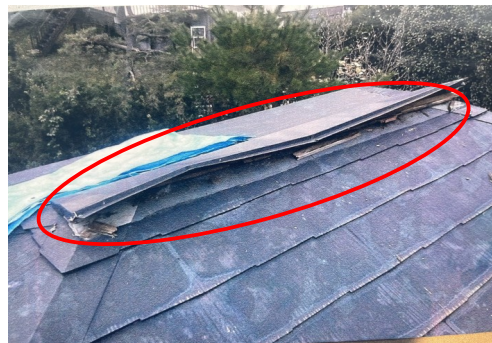
棟板金 めくれ
