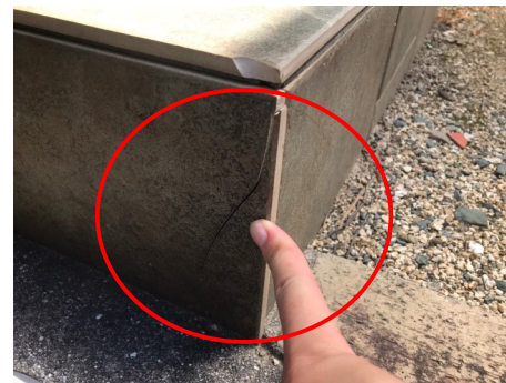
玄関ポーチ 割れ
