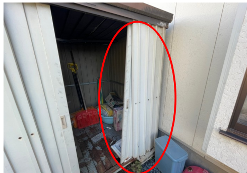
物置倉庫 破損
