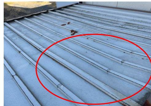
物置倉庫 破損
