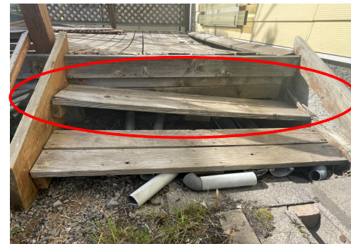
ウッドデッキ破損
