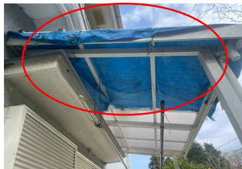
パネル吹き飛び
