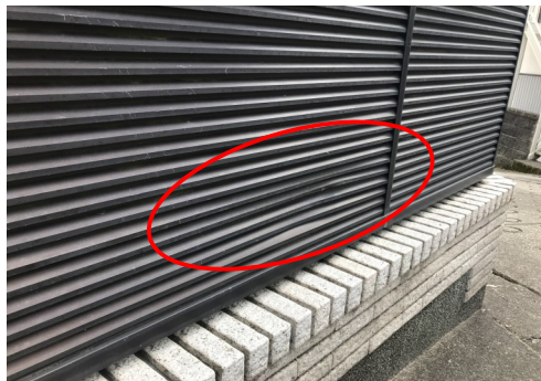
フェンス破損
