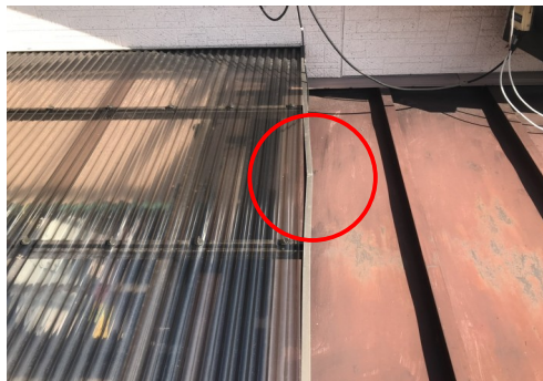
フレーム 破損
