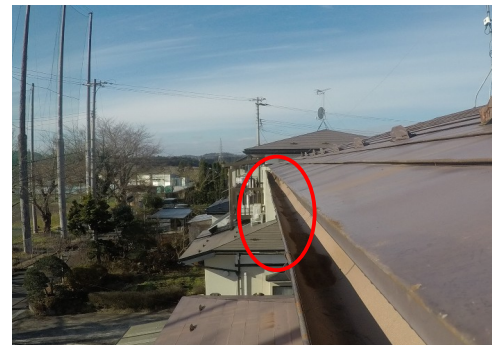
雨樋 勾配不良
